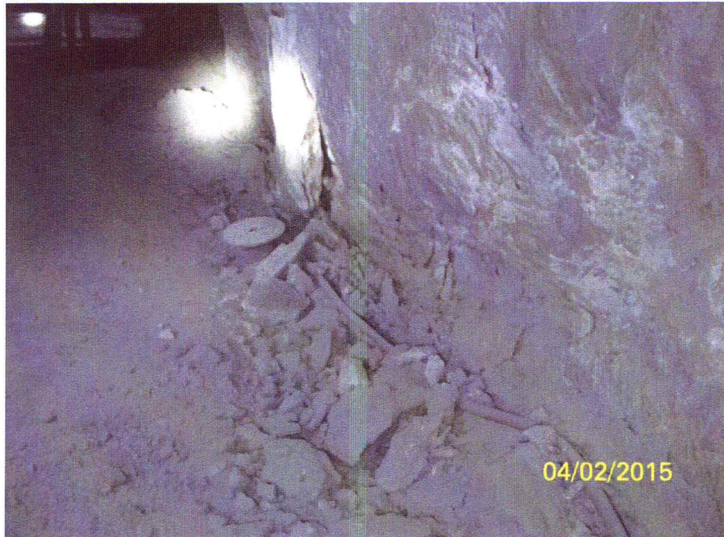
Abbildung 5: Belege für Stoßabschalungen in der 2. südl. Richtstrecke nach Westen auf der 750-m-Sohle
