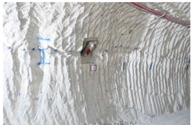
(b) 750-m-Sohle, Weststoß, Übergang der 1. südlichen Richtstrecke nach Westen zur Wendelstrecke
