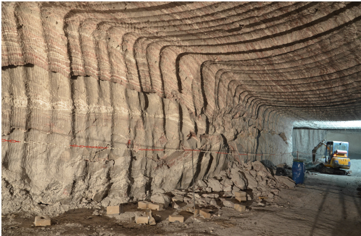
Abbildung 5: Ehemalige Umfahrung von Blindschacht 2, 750-m-Sohle, intensiv geschädigter Südstoß (Asse, 2015).
